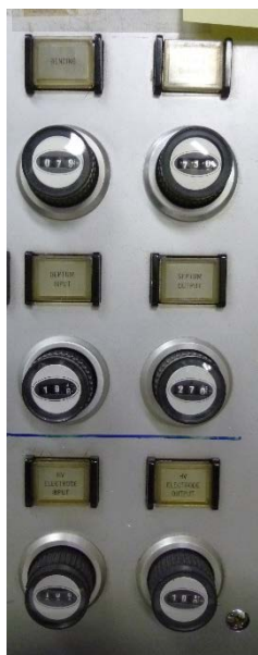
写真3.Thomson 製 デフレクタ位置駆動 制御盤
