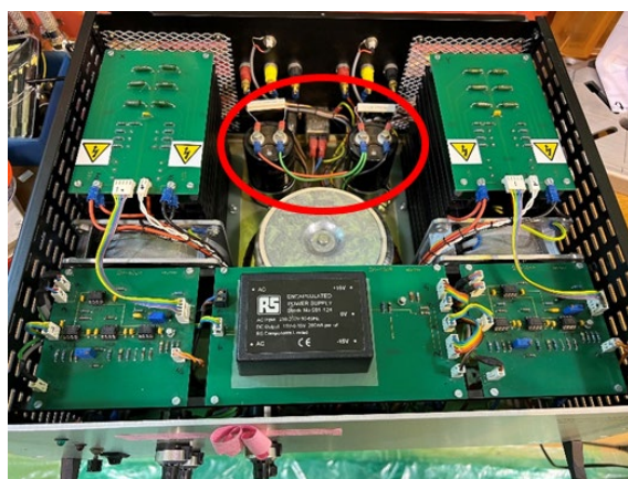
図 2. Oxford Microbeams Ltd. 社製 OM-40e ビームスキャナ用電源の内部画像 赤枠で囲んだ部分が交換修理した 10,000 \mu F 電解コンデンサ
