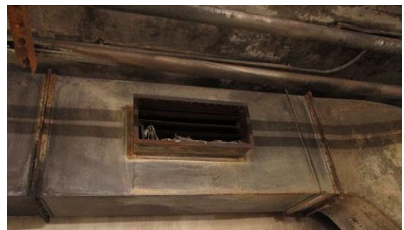
図 6. 腐食した空調ダクトと融け落ちたガラリ
